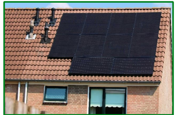
Eén van de 300 daken met zonnepanelen
